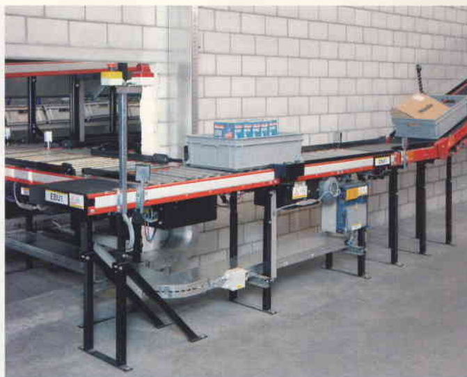
Diese automatisierte Förderstrecke verbindet die beiden Geschossebenen miteinander.
