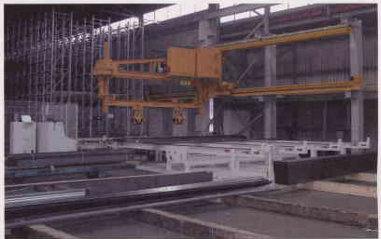
Ein- und Ausgabestation mit Kommissionierkran mit integrierten Magnettraversen auf der Seite Bahn/Lkw-Rampe. (Bilder: Agiplan)
