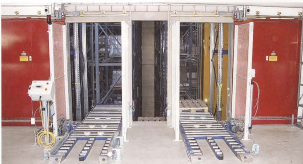
← Abb. 3: Neue Förderer kurz vor der Inbetriebnahme
